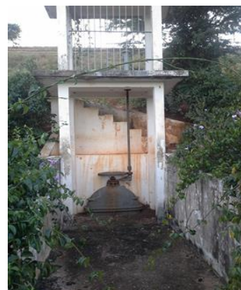
Foto 02: Torre de comando - registro gaveta.
