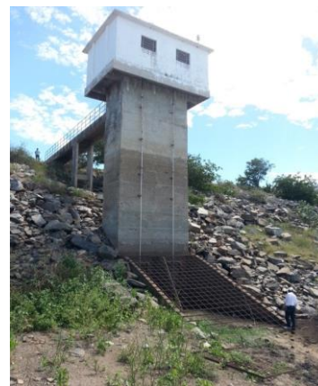
Foto 02: Torre de comando: abertura das comportas e passagem.
