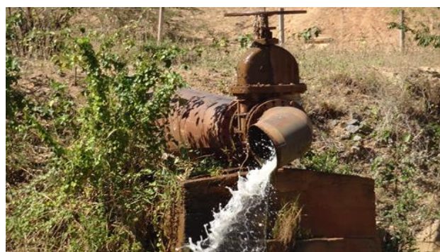
Foto 02: Tomada d'água - registro gaveta.
