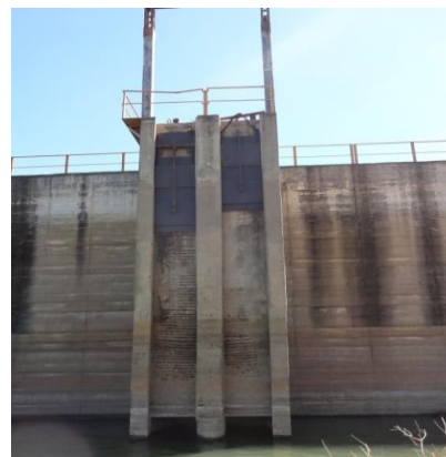
Foto 02: Tomada d'água - controle das comportas.
