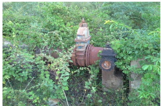
Foto 02: Registros da tomada d'água da ETA (COMPESA).
