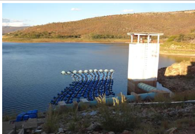
Foto 02: Torre da tomada d'água e captações sobre flutuantes.
