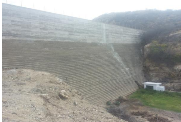
Foto 01: Vista de jusante da barragem e casa de controle da tomada d'água.
