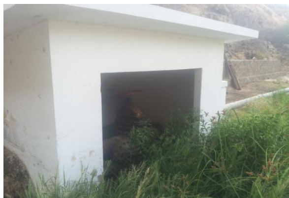
Foto 02: Válvula da tomada d'água.
