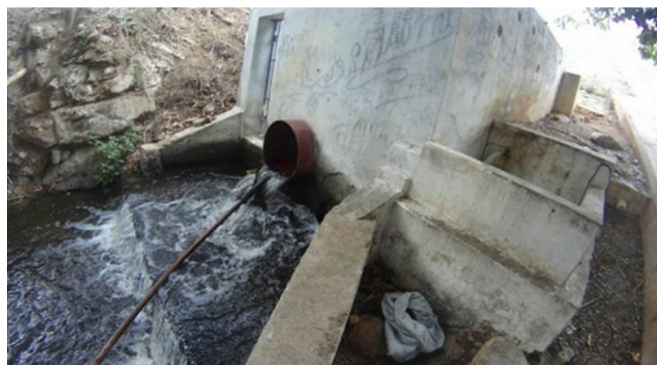
Foto 02: Tubulação de liberação para jusante.
