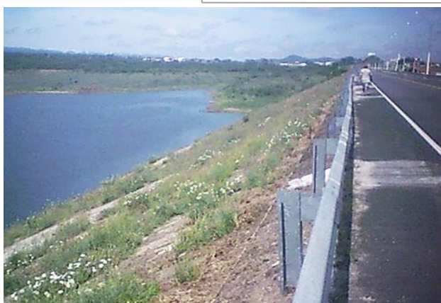
Foto 01: Paramento de montante com vegetação.
