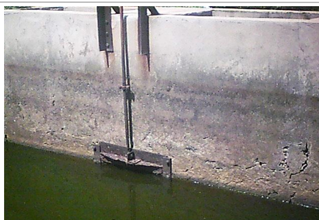
Foto 02: Comporta de controle da tomada d'água.
