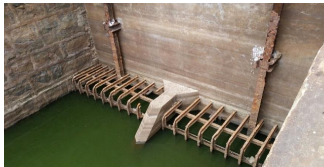
Foto 02: Grades instaladas Nas comportas da tomada d'água.
