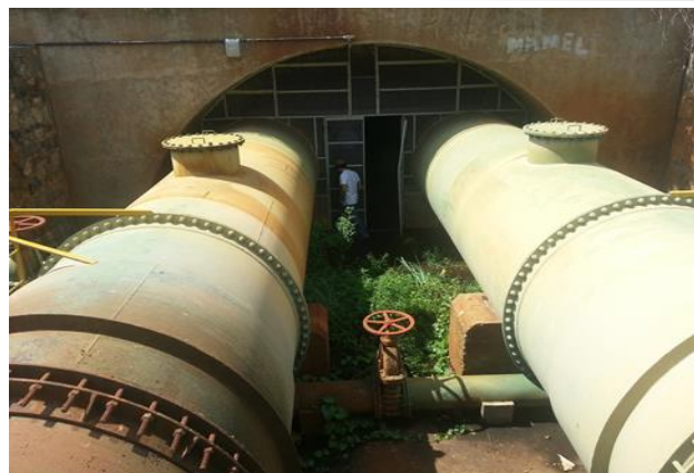
Foto 02: Tomada d'água - tubulações e controle.
