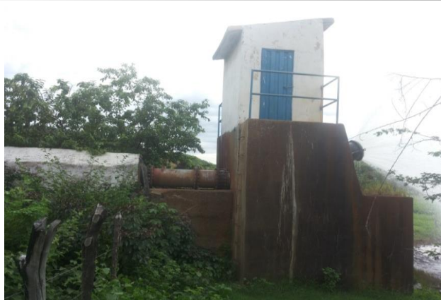
Foto 02: Tomada d'água - válvula dispersora.
