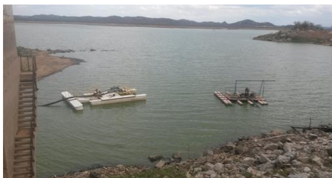
Foto 02: Bombas sobre flutuantes - abastecimento humano.
