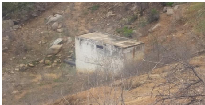
Foto 02: Tubulação de liberação para jusante.
