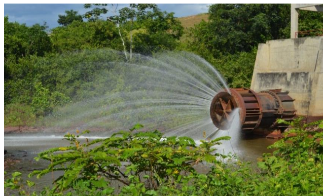
Foto 02: Válvula dispersora - liberação para jusante.
