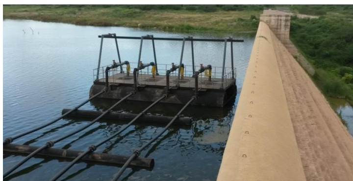
Foto 02: Captação flutuante do Sistema Adutor Sudeste Piauí.
