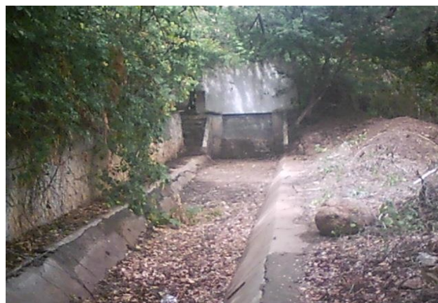
Foto 02: Tomada d'água com função de liberação para jusante.
