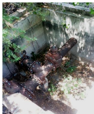
Foto 02: Controle entre adutora de Serra Branca e liberação para jusante.
