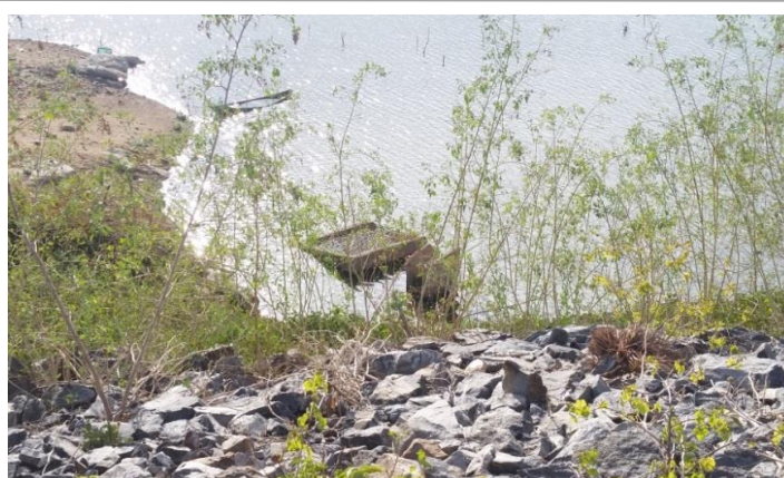
Foto 02: Tomada d'água - Captação São Seb. do Umbuzeiro e Zabelê.
