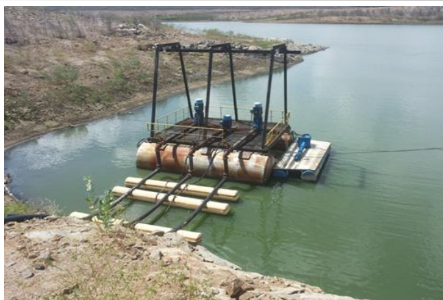
Foto 02: Bombas sobre flutuantes - captação Itatuba.
