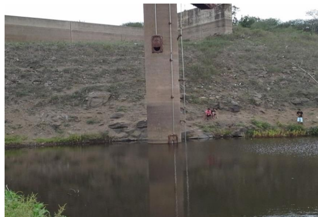
Foto 02: Comportas na torre de comando.
