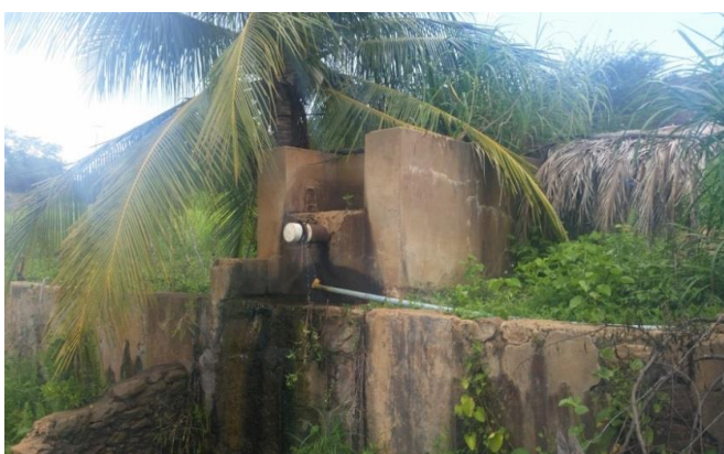
Foto 02: Estrutura de liberação para jusante.
